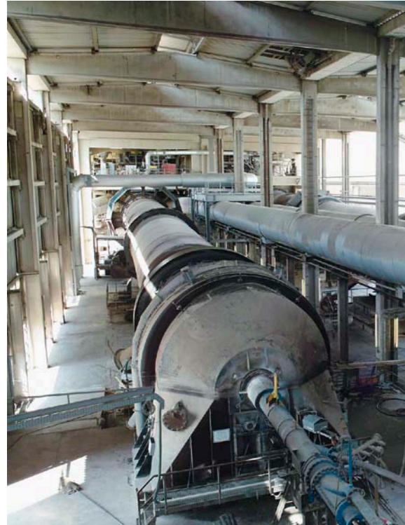
Klinkerproduktion in Drehrohröfen
