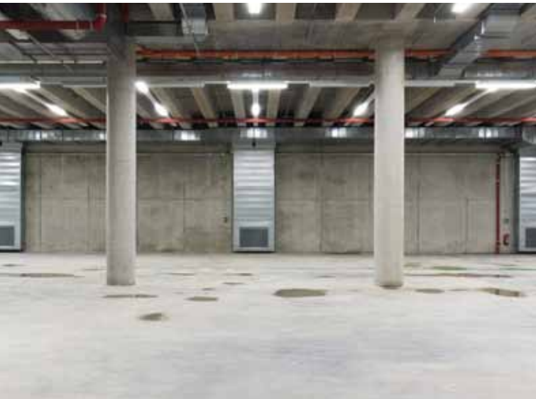
Lagerraum unmittelbar vor Inbetriebnahme.
