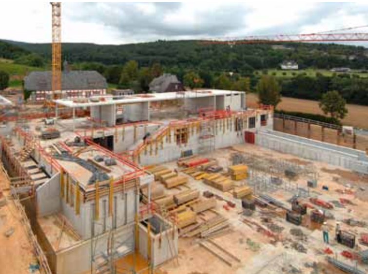
Baustellentotale: Im oberen Bildabschnitt unter Denkmalschutz stehende Bestandsbauten; im unteren Bildabschnitt entstehende unterirdische Hallen.
