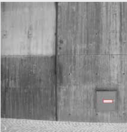
Schwarzer Ort beton mit Ausblühungen, Parkhaus, München
